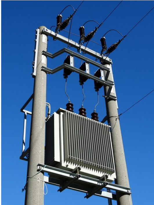
Abb. Transformator in einem Elektrizitätswerk
